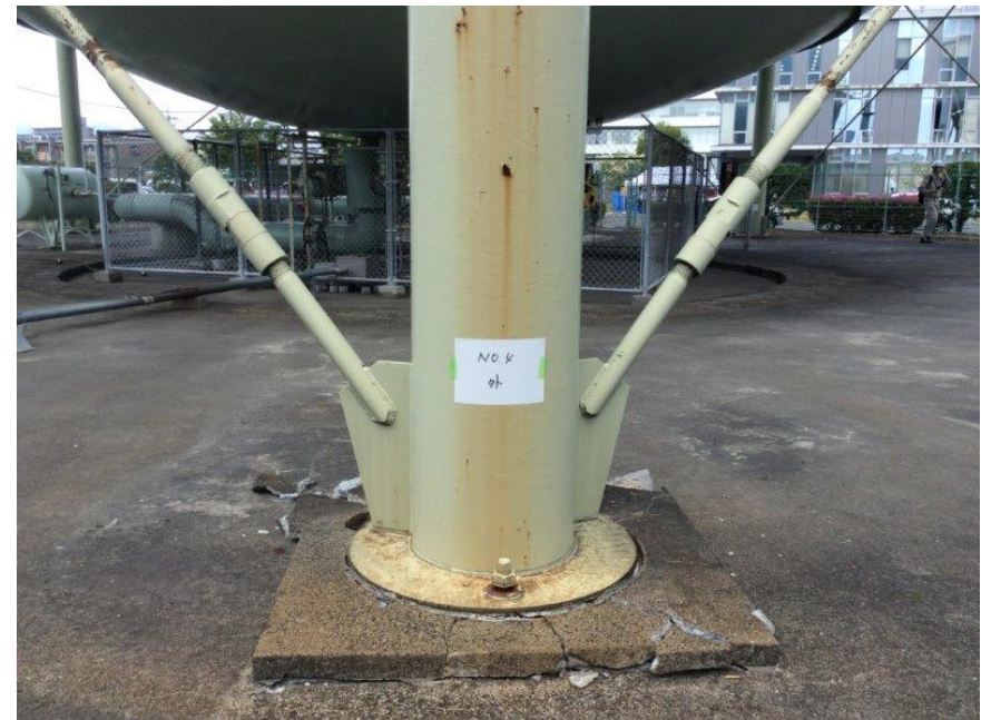
基礎の一部ひび割れ
