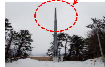
＜風車の羽根の脱落＞
