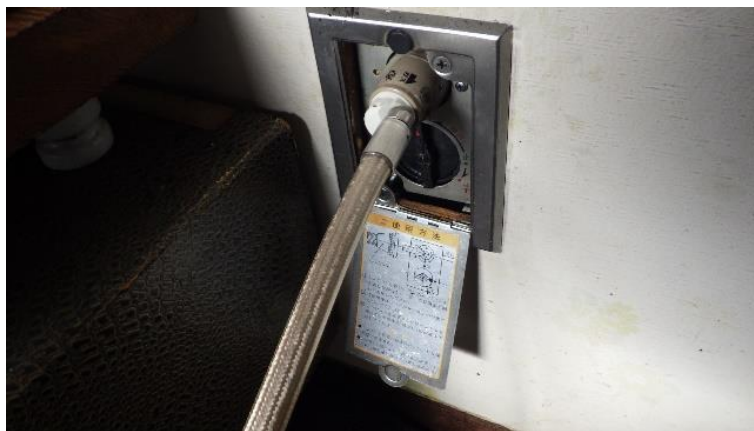
ガス栓及びガスコード
