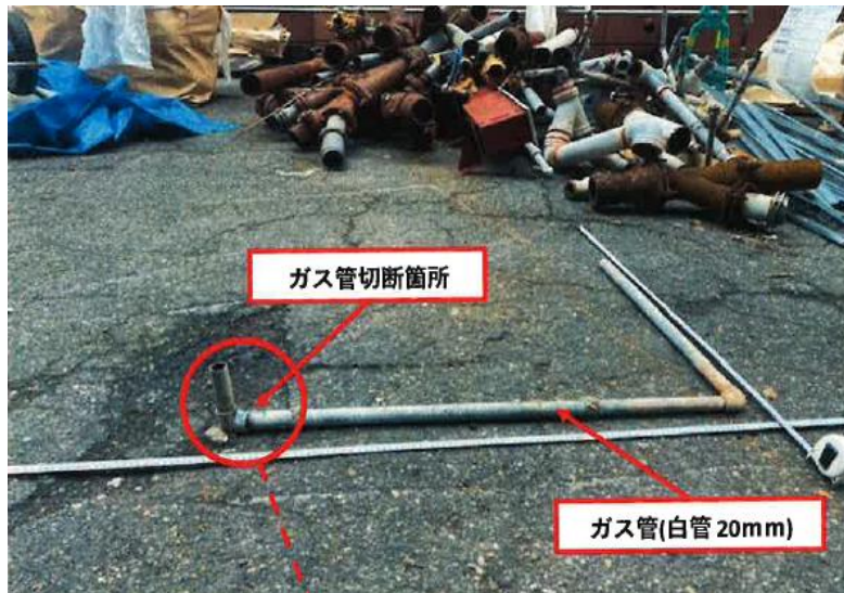
切断されたとと思われるガス管
