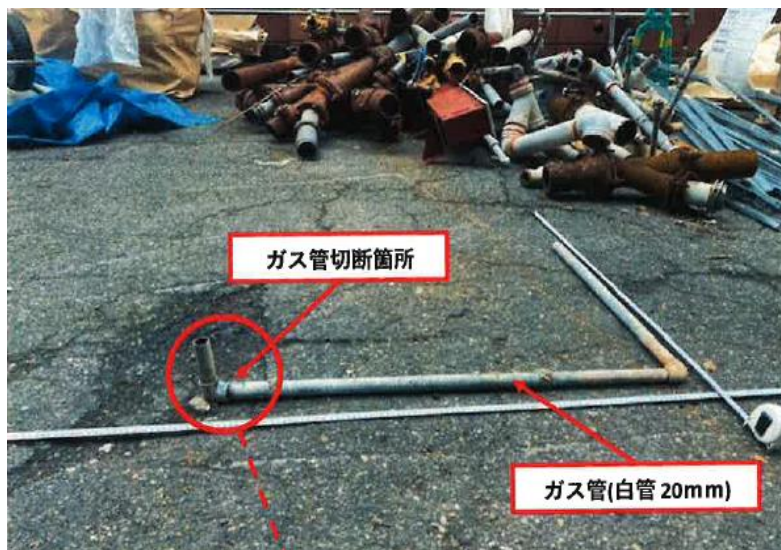
切断されたと思われるガス管
