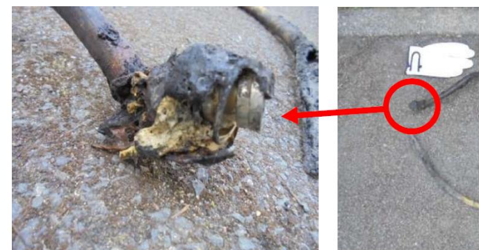
損傷したソフトコード（迅速継ぎ手あり）
