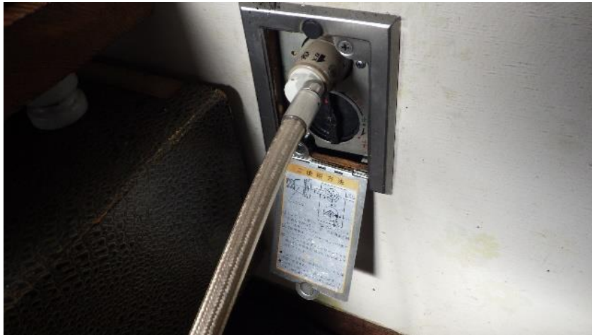
ガス栓及びガスコード
