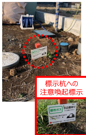
▲ 視認性の高い埋設部標示
