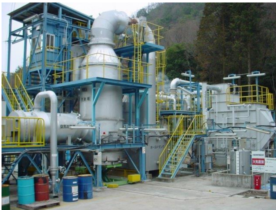
【ダイセル播磨工場 回収処理設備】
