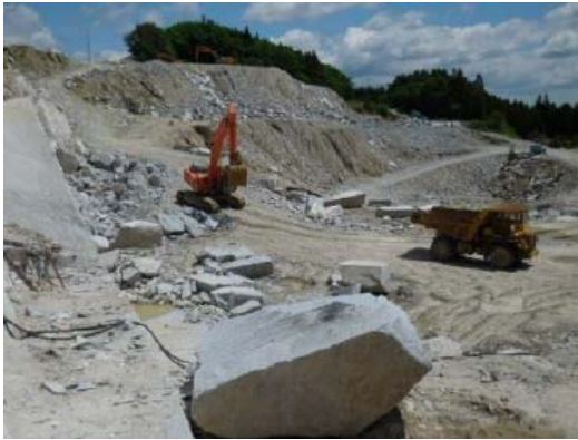
装填箇所から見た装填箇所方向
