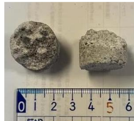
<落下した詰め物>
