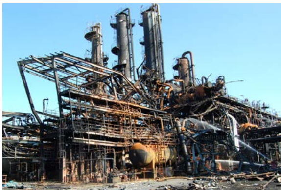
写真1 被災状況全体
