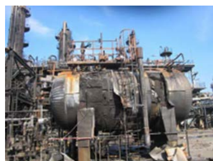
写真 4 液塩酸一時受タンクの損傷状況
