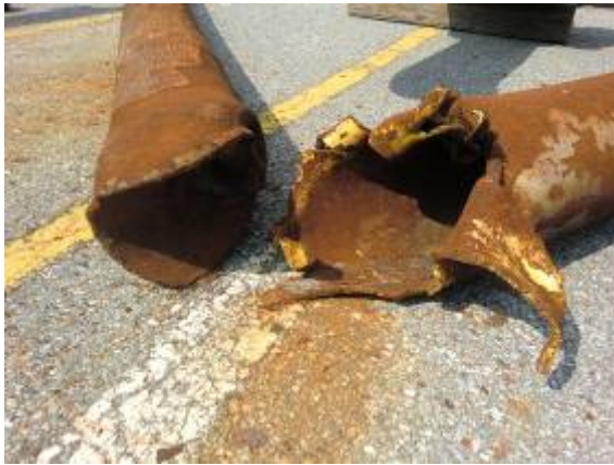
写真 8 破断したブレース(溶接部)
