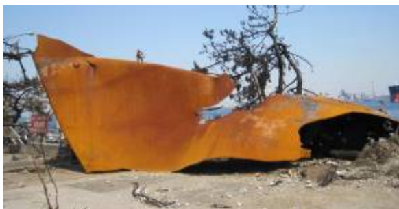
写真 4 貯槽破裂後に飛散した破片
