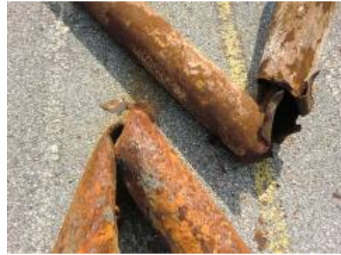
写真 7 破断したブレース (交差部全体)
