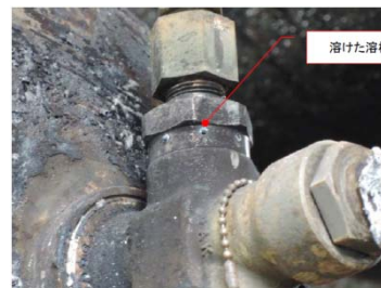
溶栓弁付き元弁の状況 →溶栓は120℃で溶けるので、 作動し水素が放出されたと推測。
