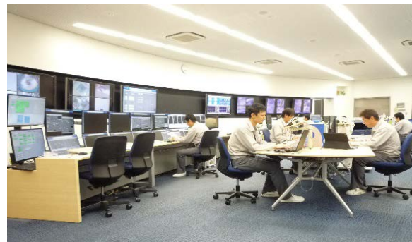
アラームマネジメントの導入により 約8割のアラームを整理・削減した監視室
