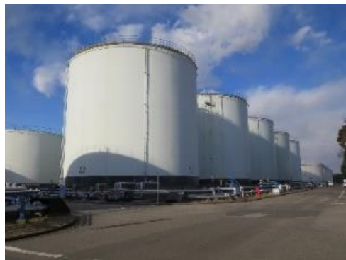
実証対象となるタンク
