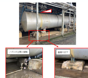
脱圧槽沈下状況（事業所提供）
