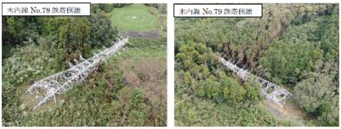
倒壊した鉄塔の様子（木内線No.78,79）
