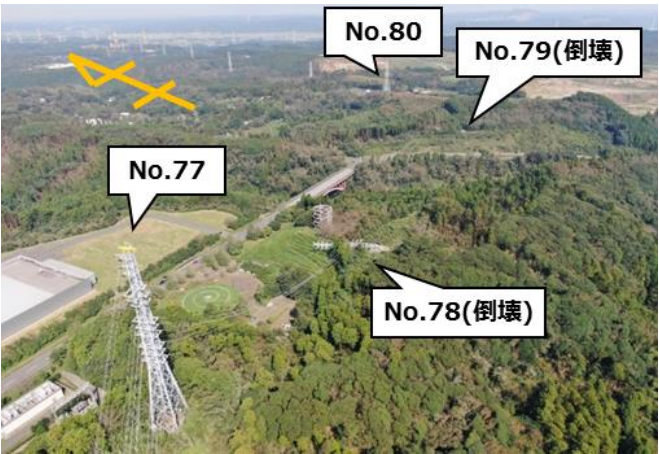
倒壊現場の様子
