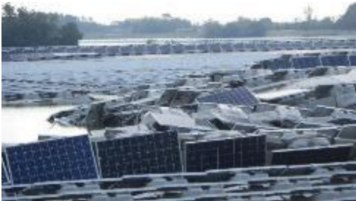
台風15号 強風による水上設置型太陽電池 発電設備の損壊事故（千葉県市原市）
