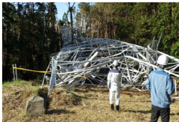
転倒した鉄塔
