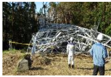
<倒壊した鉄塔（No.78）>
