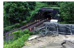
＜太陽光パネルの崩落＞
