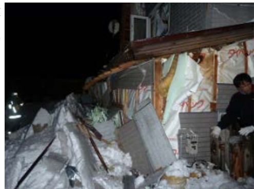
※雪害により漏えいしていたガスに引火
