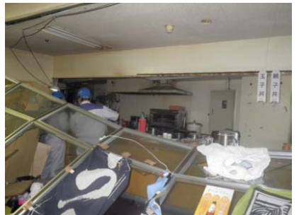
※（現場写真）爆発で店舗が損傷
