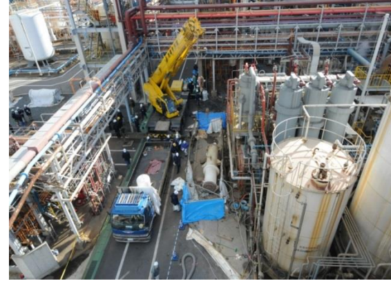
多結晶シリコン製造施設の爆発死亡事故 平成26年 1月 死者5名 負傷者13名
