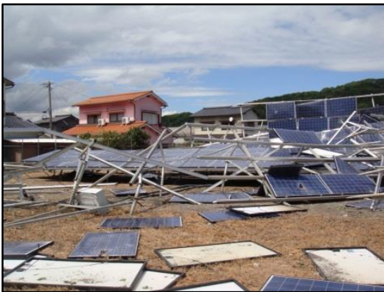
平成27年8月 九州地方 台風15号に伴う太陽光発電設備の破損事故
