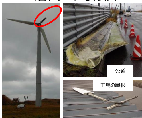
【北海道 オロロン風力発電所】 （平成25年12月、単機出力400kW）
