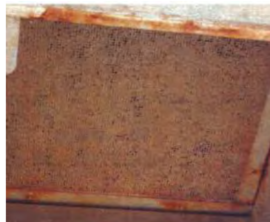
目詰まりしている給気扇のフィルター
