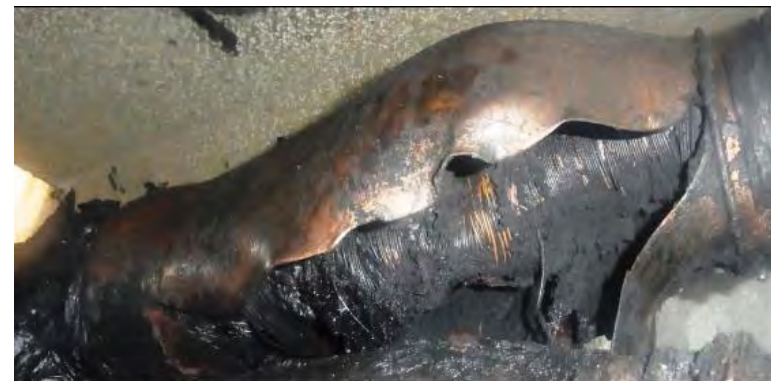
10/12の送電設備火災の火災事故現場状況
