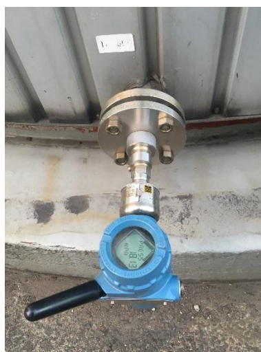
タンクに設置された 無線通信機能付き液面計
