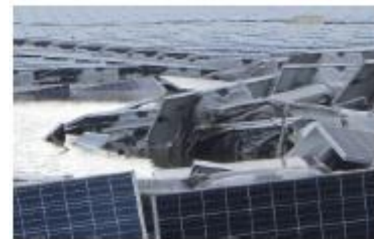
＜水上設置型太陽電池発電所発電設備転倒・破損事故＞
