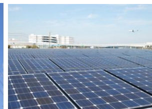
(太陽光パネル)
