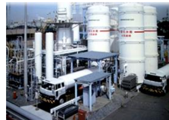
(コンビナート・高圧ガスプラント)
