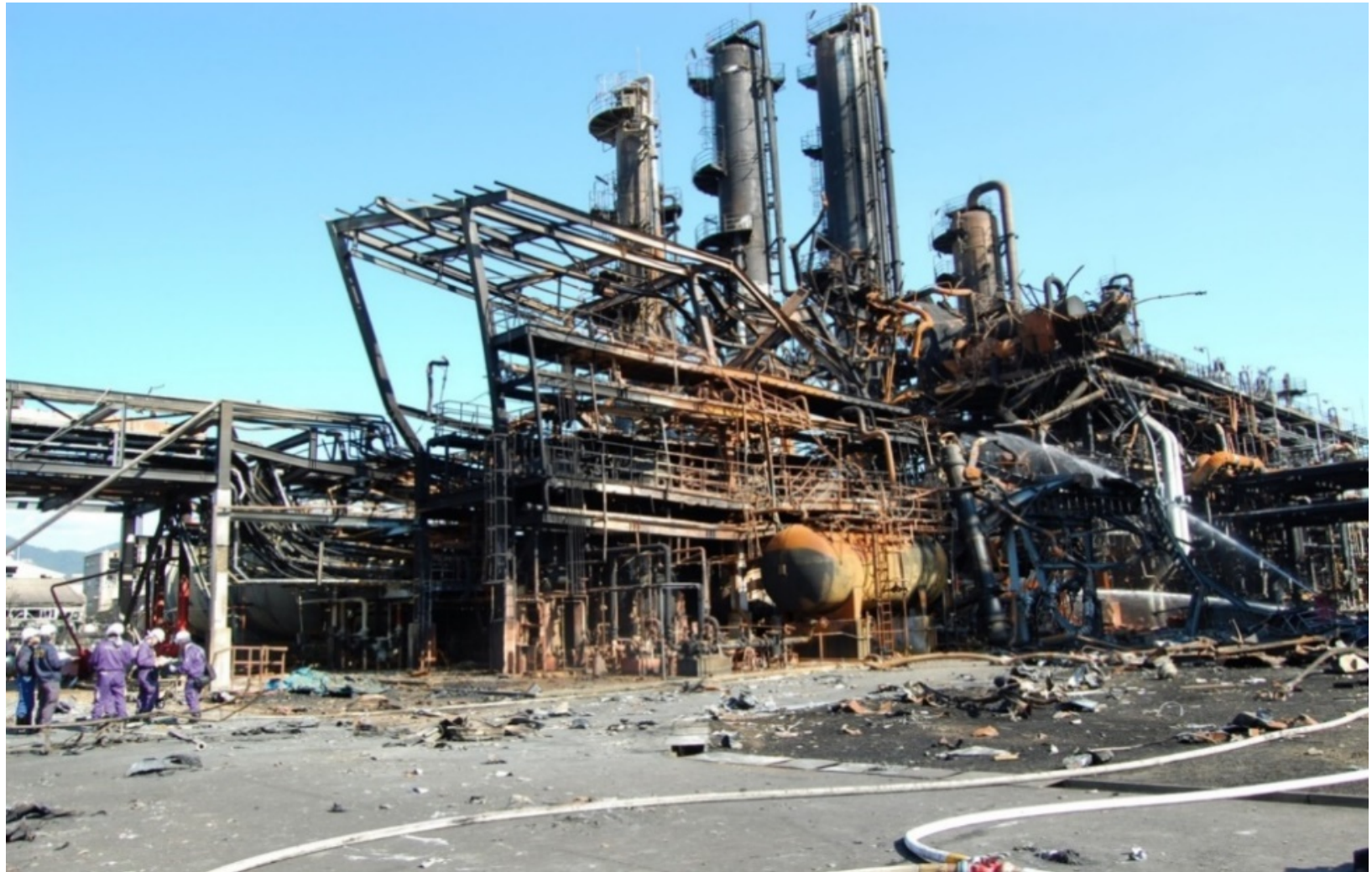
被災状況全体
