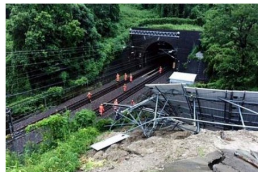
小出力太陽電池発電設備の崩落事故
