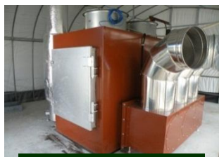
木質バイオマス利用 加温設備
