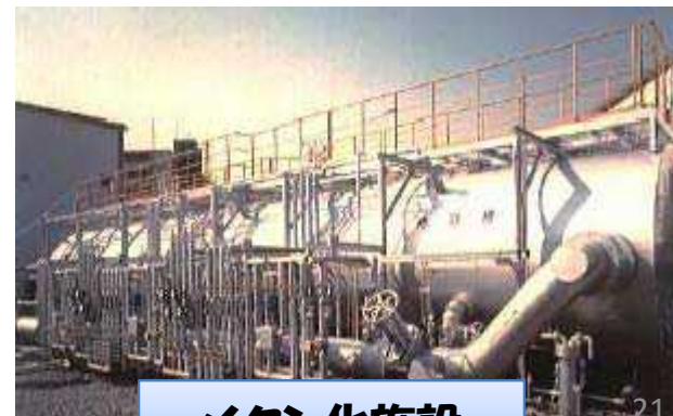
メタン化施設
