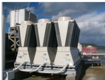
高効率空調設備 （チリングユニット）
