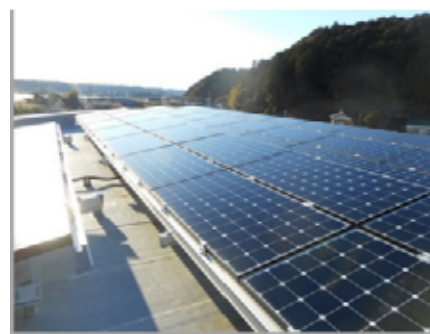
太陽光発電設備
