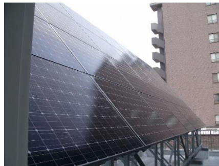
太陽光発電設備
