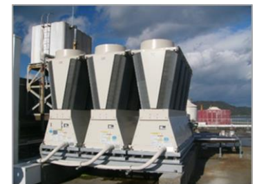
高効率空調設備 （チリングユニット）
