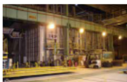
Fig.4 グラスライニング 世界最大の1号炉
