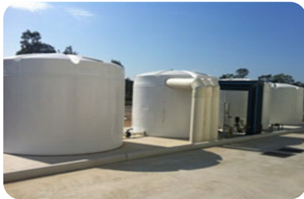
③雨水の貯蔵タンク
