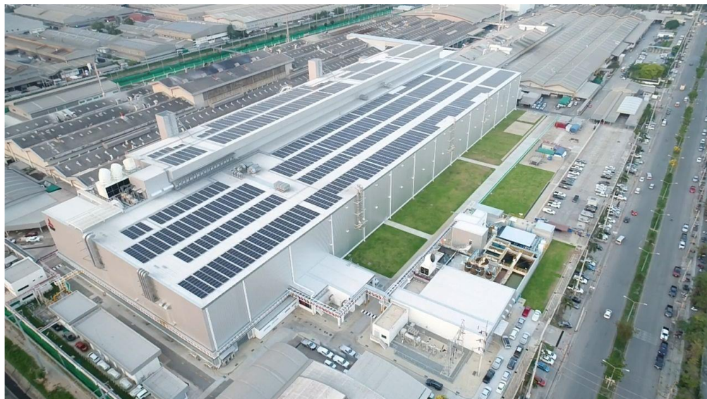
タイの新塗装工場屋上に設置された太陽光発電設備
