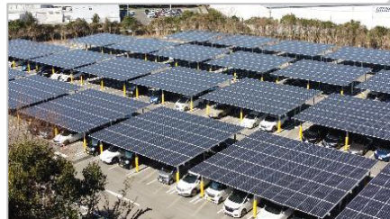
カーポートソーラー 1650KW
