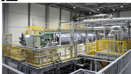
10MWの水電解装置
