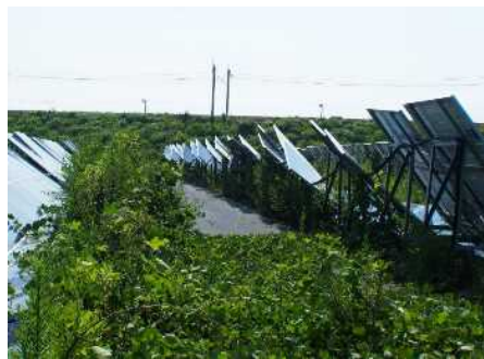
不十分な管理で放置されたパネル
