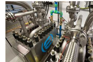
水素製造装置
