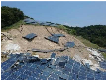
土砂崩れで生じた崩落
