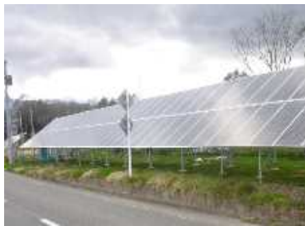
柵塀の設置されない設備
