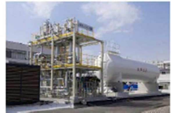
ごみ焼却工場の排ガスからのCO 2 回収とメタネーションの利用実証
