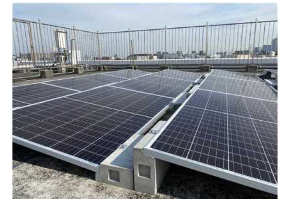
小中学校への太陽光発電設備設置
