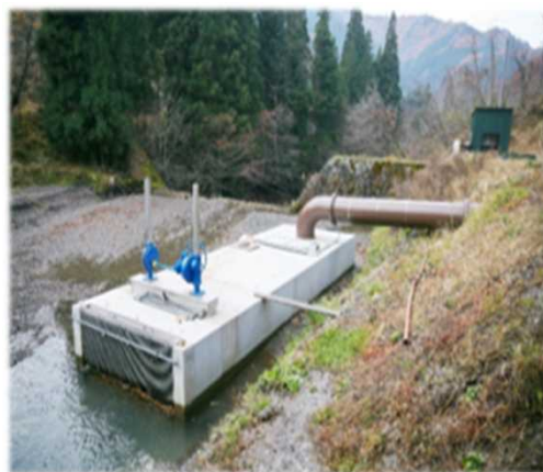
小水力発電施設
