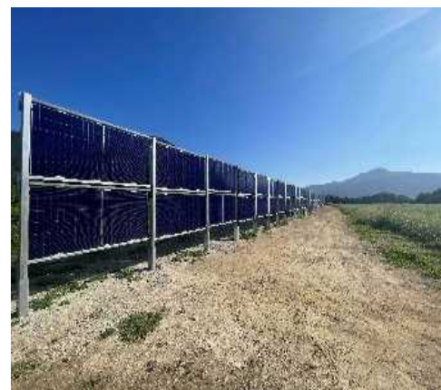
牧草地におけるソーラーシェアリング
