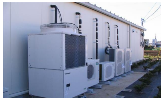
CO 2 冷媒の室外機
