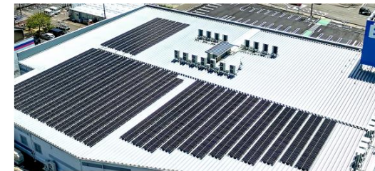
エディオン岐阜正木店 太陽光発電設備
