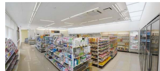
環境配慮型店舗(LED照明)
