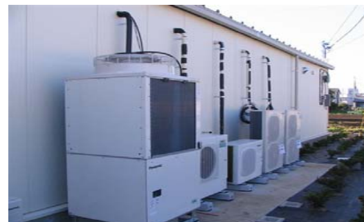
CO 2 冷媒の室外機
