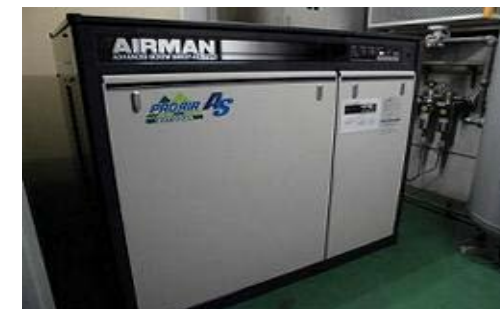
最新のコンプレッサーへ更新の例
