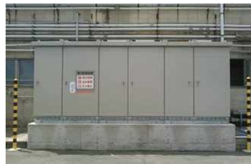
トップランナー変圧器へ更新の例
