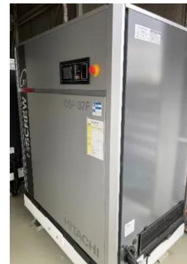
最新のコンプレッサーへの更新
