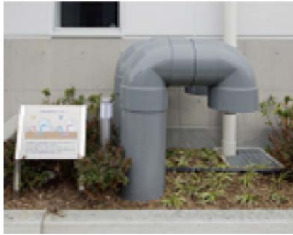
地中熱利用空調（吸気口）
