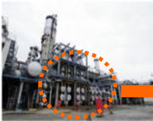
高効率熱交換器への入れ替え
