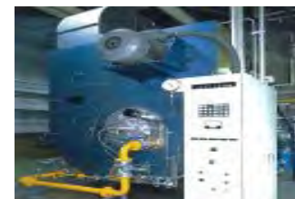
蒸気ボイラー
