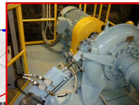
水車・発電機
