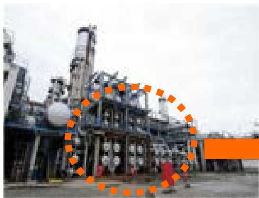
高効率熱交換器への入れ替え
