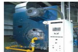
高効率蒸気ボイラー
