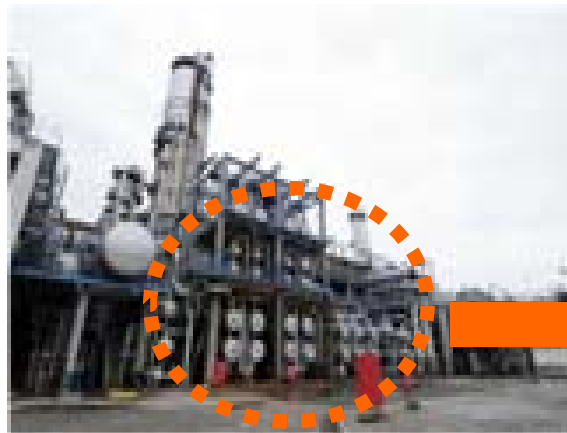
高効率熱交換器への入れ替え
