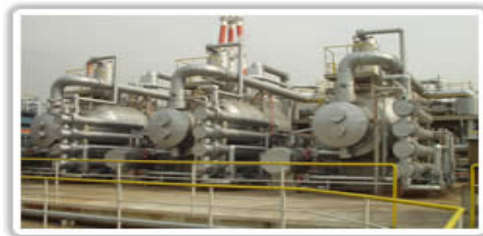
蒸気発生設備
